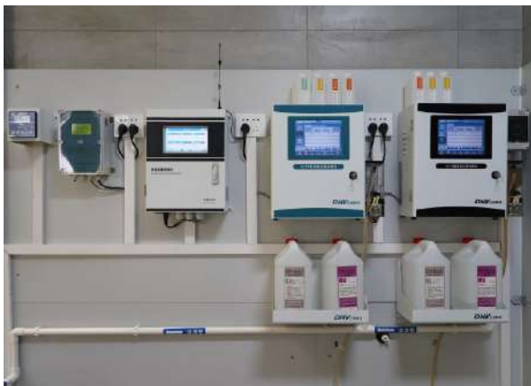
某电镀厂水质监测站房
