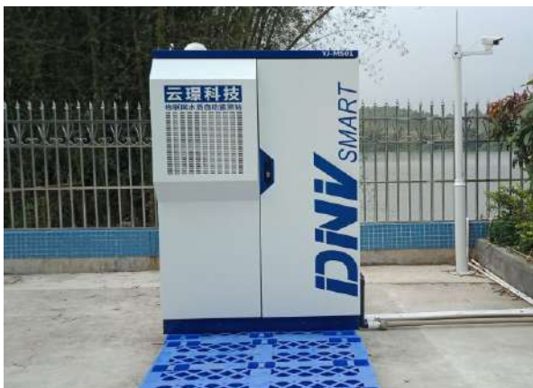
环境地表水在线监测（钦州国控断面站）
