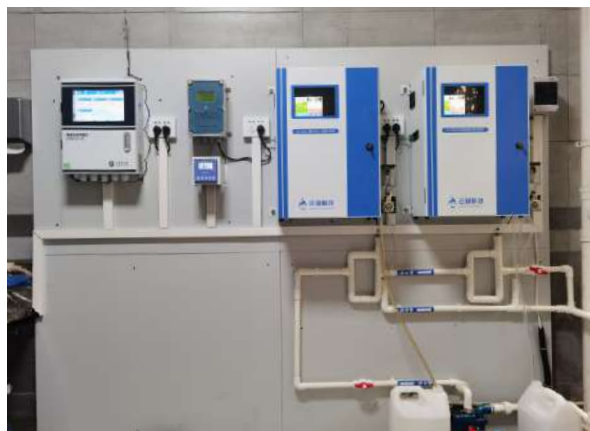
某食品加工厂排放口监测站房
