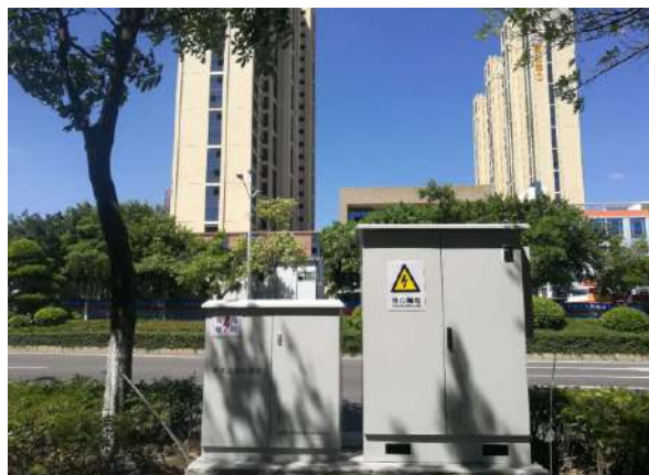
泉州市污水管网水质监测站
